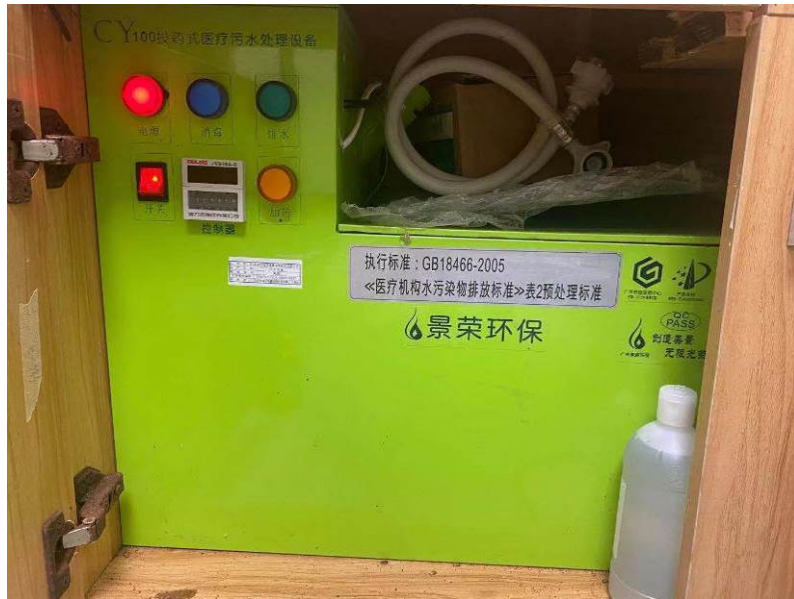
手术室医疗废水处理设施
