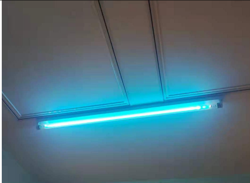
项目已安装紫外消毒灯管
