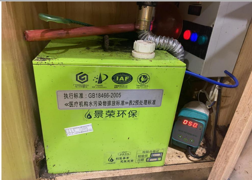
医疗废水处理设施
