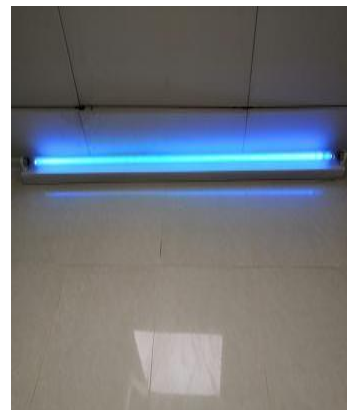
项目已安装紫外消毒灯管
