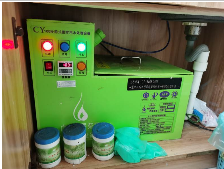
图 3-2 项目已安装 CY100 投药式医疗污水处理设备及所用消毒剂照片
