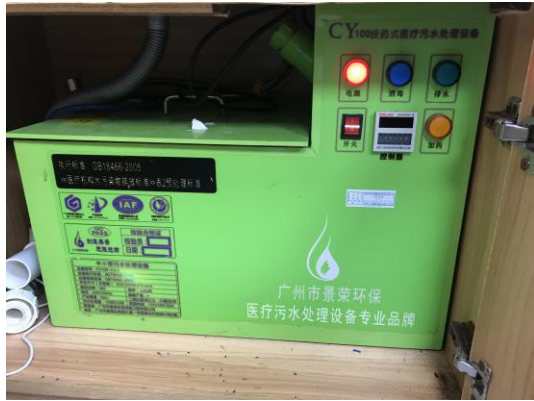
医疗废水处理设施
