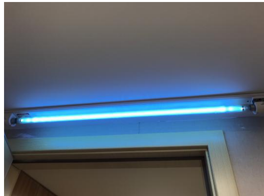
项目已安装紫外消毒灯管
