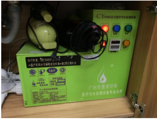
医疗废水处理设施
