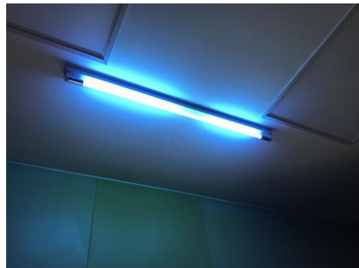
项目已安装紫外消毒灯管
