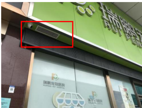
医院通排风口
