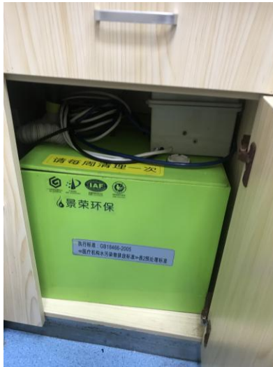
医疗废水处理设施
