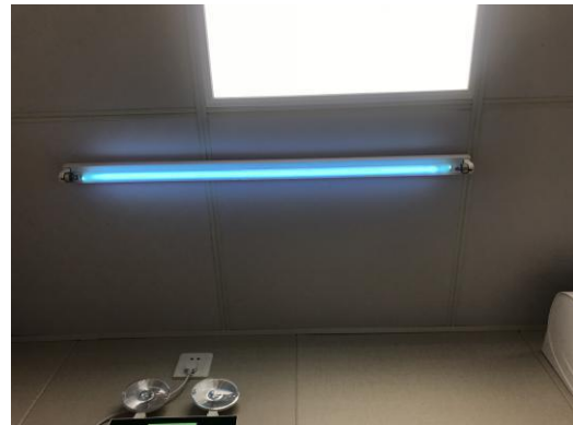
项目已安装紫外消毒灯管
