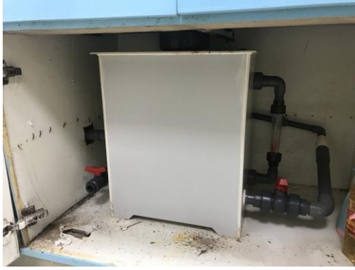
医疗废水处理设施
