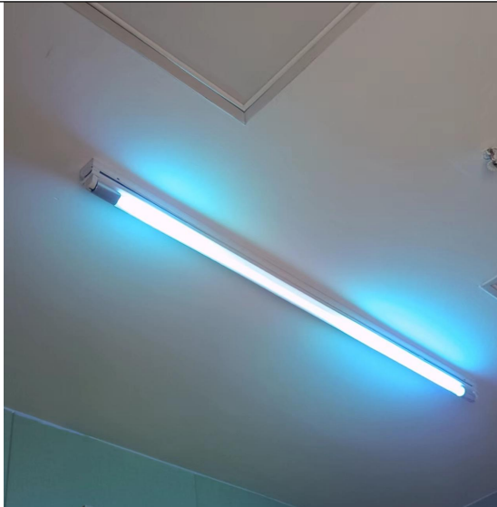
项目已安装紫外消毒灯管
