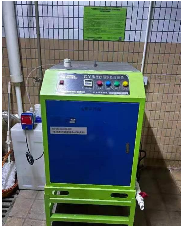
项目已安装医疗废水处理设施
